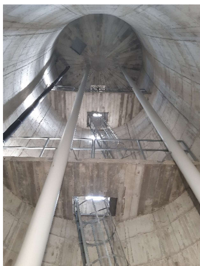
Colonnes d'eau du réservoir de la Charpraie
