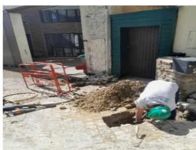
Clisson – Place de la Trinité – fuite sur branchement PVC collé
