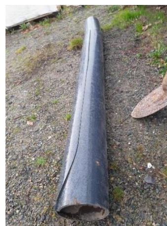
St-Fiacre-Sur-Maine – Fuite sur une conduite en 200PVC
