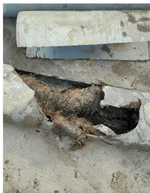
Racines présentes dans la canalisation
