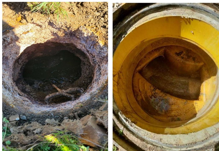
Exemple d'un regard très dégradé, et son remplacement par un regard en polypropylène.
