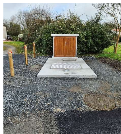
Poste de relevage Arceau à Boussay.
