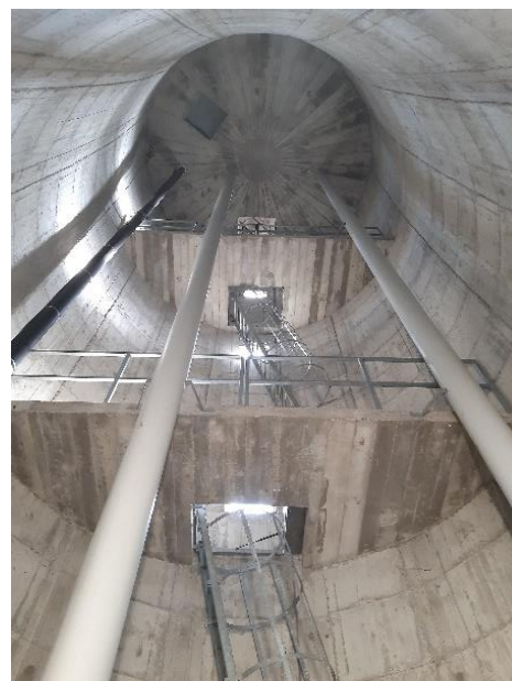
Colonnes d'eau du réservoir de la Charpraie à Gétigné.
