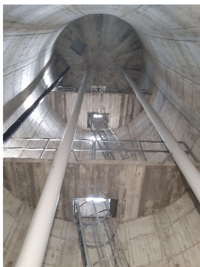
Colonnes d'eau du réservoir de la Charpraie
